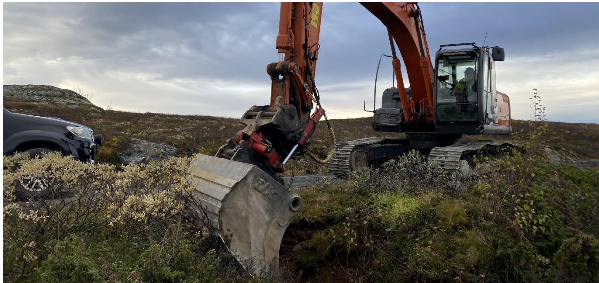
Ivar Kalstrup fra Gausdal Bilselskap AS tar grøfterensk langs Revsjøvegen, 20. september 2023 (foto: Gausdal fjellstyre)
